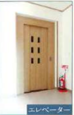
エレベーター
